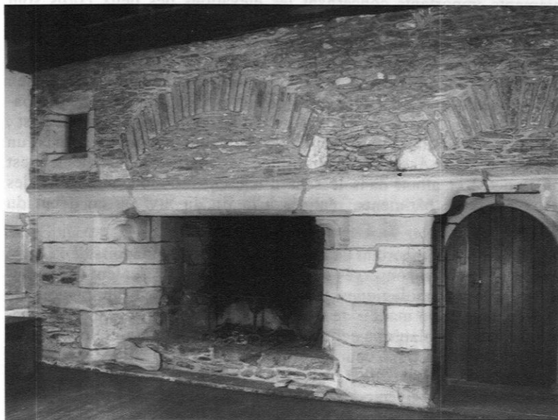
Cheminée de l'ancienne salle sous charpente ; à droite, porte d'accès à la chambre en demi-niveau ; à gauche, jour de surveillance
