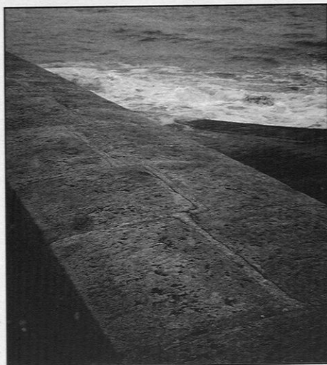
Figure 19 – Couronnement du parapet de la jetée de Saint-Jacques, en granite de l'Île-aux-Moines.
