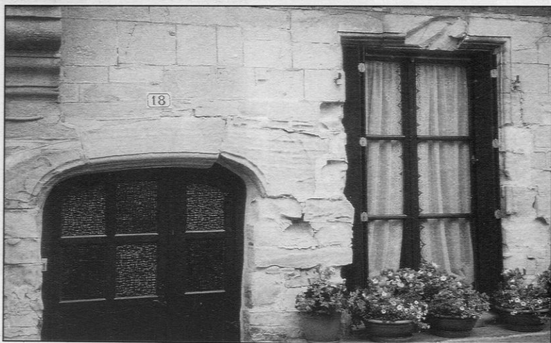
Rue du Rachapt, n° 18. Profonde érosion du grès.
