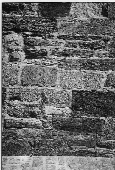
Détail de l'élévation dans la partie inférieure du châtelet. Répartition aléatoire du schiste bleu et du granite ocre.
