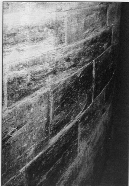
Tour Saint-Laurent. Mur intérieur du chemin de ronde en schiste bleu bien façonné.
