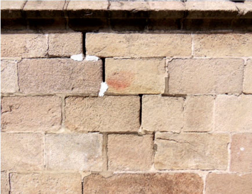
Photo 10 – Minihy-Tréguier, l'église ; élévation méridionale de l'église : vers l'urgence des travaux de restauration
